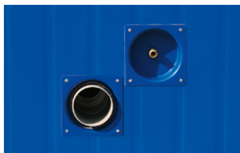
Vodovodní přípojka zapuštěná ve stěně
